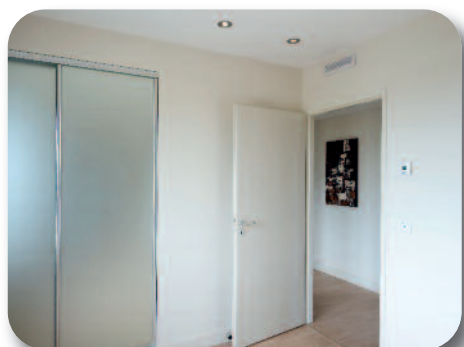
Bouche d'insufflation - Chambre.
