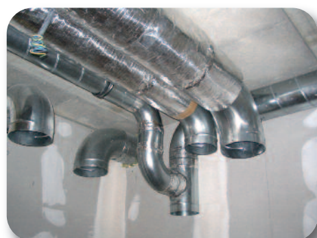
Réseau rigide calorifugé - En faux-plafond.
