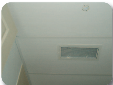
Grille de recyclage - En faux-plafond.
